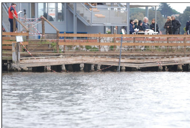
Il pontile di Sabaudia danneggiato (ph CM)
